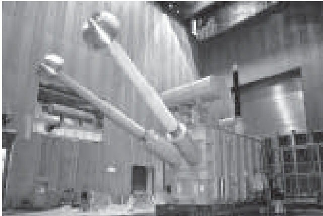
400 केवी क्लास एचवीडीसी कंटवर्टर ट्रांसफॉर्मर का ±800 केवी 6000 मेगावाट, मल्टी टर्मिनल एचवीडीसी एनई आगरा प्रोजेक्ट के लिए बीएचईएल, भोपाल में परीक्षण किया जा रहा है।
